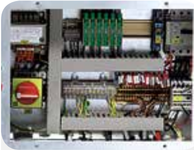
Quadro Elettrico (fusibili con spia di segnalazione guasto). Electric Panel (fuses with fault indicating light). Schaltschrank (Schmelzsicherungen mit Kontrolleinheit zur Störungsanzeige). Tableau Électrique (fusibles avec voyant de signalisation de panne). Tablero Eléctrico (fusibles con indicador de señalización avería). Электрический щит (предохранители с аварийным индикатором)
